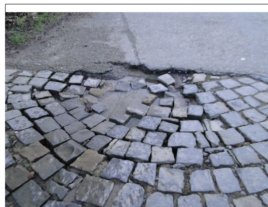
Pavement disloqué à plusieurs endroits
